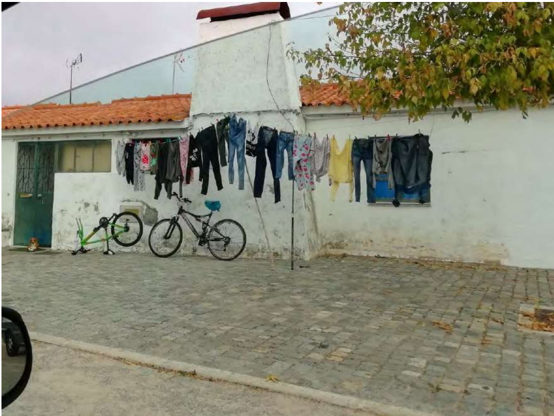
Imagem 11 - Exterior de habitação do Bairro Martinho Chaveiro Rovisco Pais revelando problemas de infiltrações e humidades
