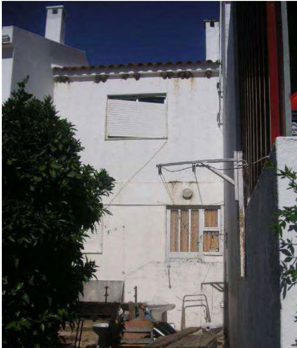
Imagem 10 - Exterior de habitação do Bairro Sá Carneiro revelando problemas de infiltrações e humidades
